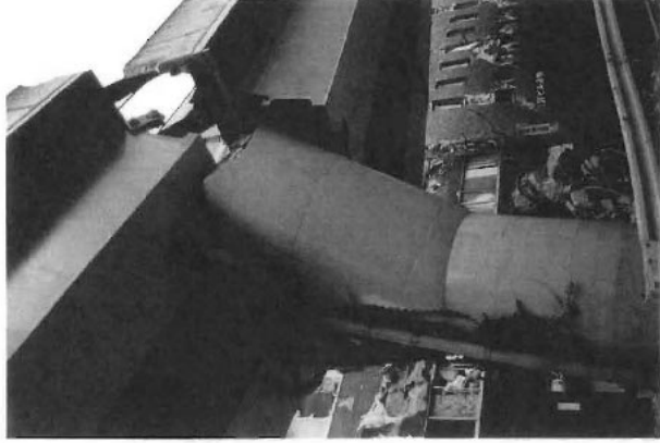
新交通ポートアイランド線の桁（けた）落下
