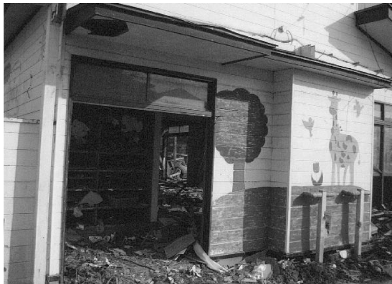
津波で破壊された保育園
